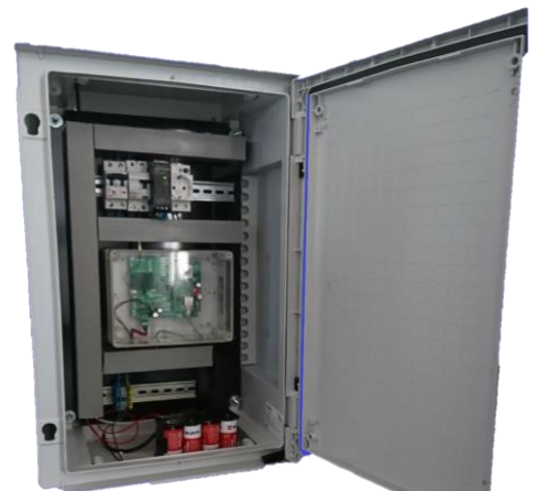
Estación Base – concentradora
